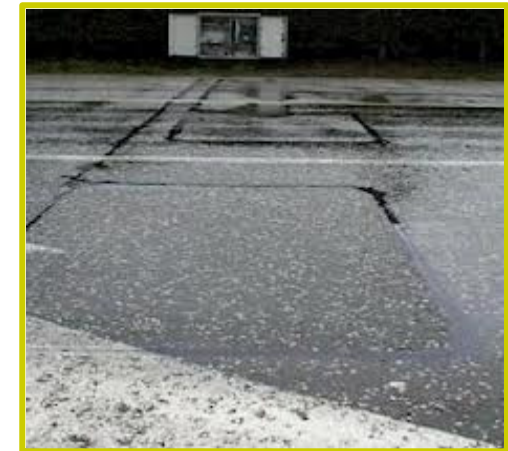
Afbeelding 7: Meetlussen (inductielussen) in het weadek.
