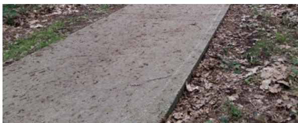
Afbeelding A.3 Voorbeeld van een onvoldoende veilige berm langs een betonverharding
