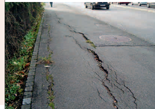
Eingeschränkter Komfort, gefährliche Längsrisse im Belag | Confort limité, fentes dangereuses dans le revêtement en dur | Confort limitato, crepe pericolose nella pavimentazione in asfalto
